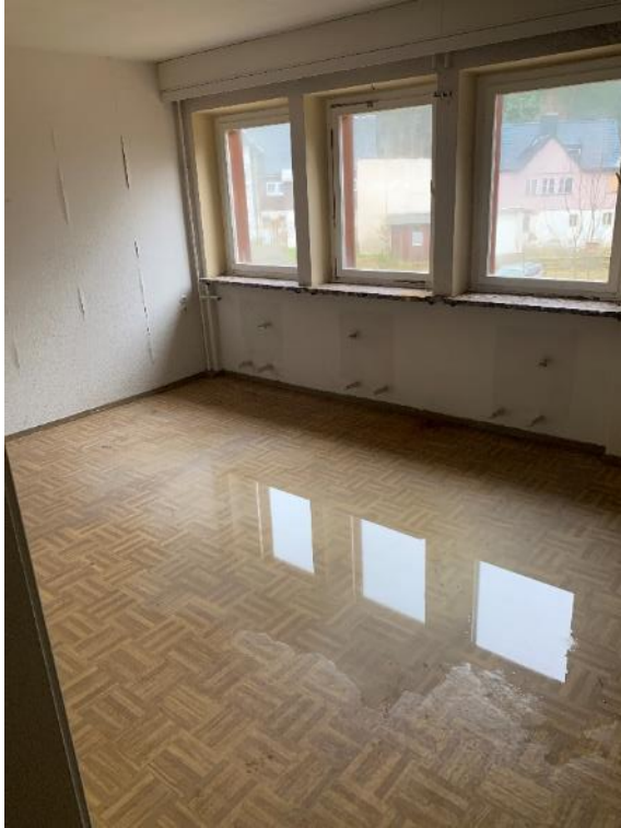
Abbildung 6: Wasserpfütze in Nebenraum.
