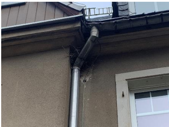
Abbildung 26: Taubennest an südwestlicher Hauswand.
