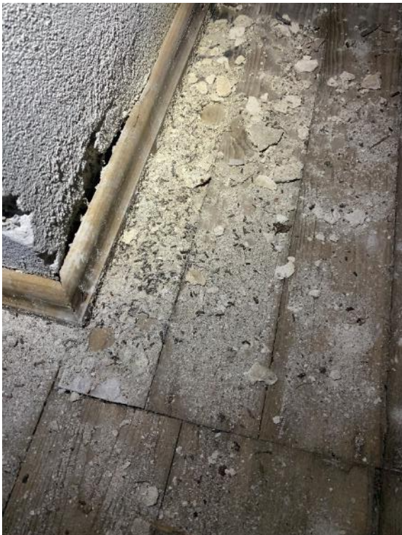
Abbildung 12: Kot einer spaltenbewohnenden Fledermaus auf dem Dachboden.
