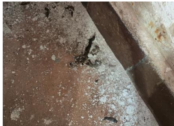
Abbildung 18: Kot vom Marder im Keller.
