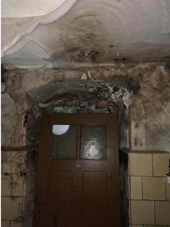
Abbildung 19: Großflächiger Hausschwamm in Kellerabteil.
