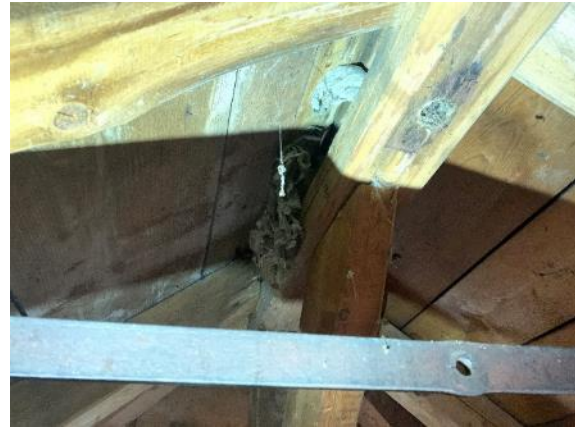
Abbildung 23: Altes Wespennest auf dem Dachboden.
