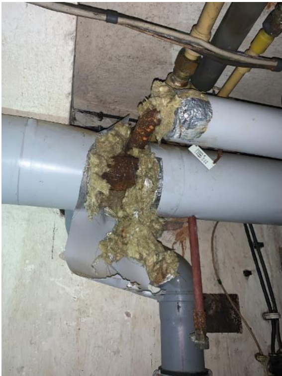
Abbildung 21: Zerlegtes Rohr, Hinweis auf Marder.
