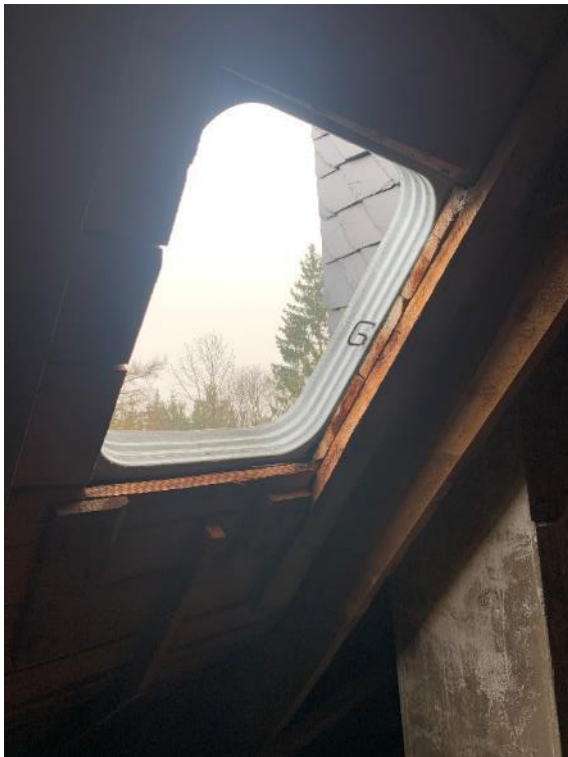
Abbildung 8: Fenster ohne Glasscheibe auf dem Dachboden.
